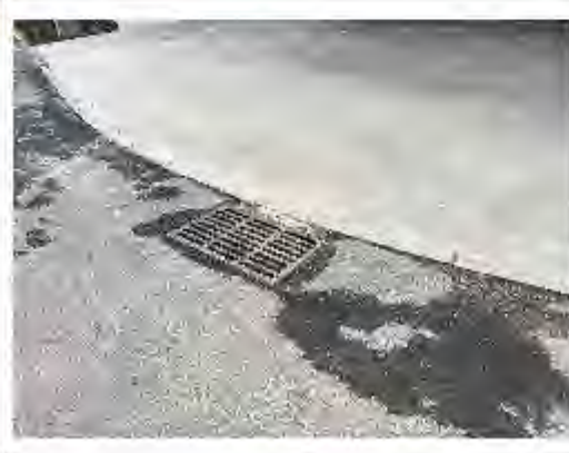
雨水管网、雨水口
