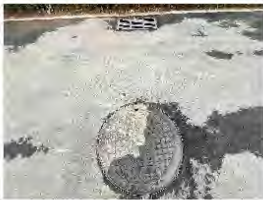
雨水管网、雨水口
